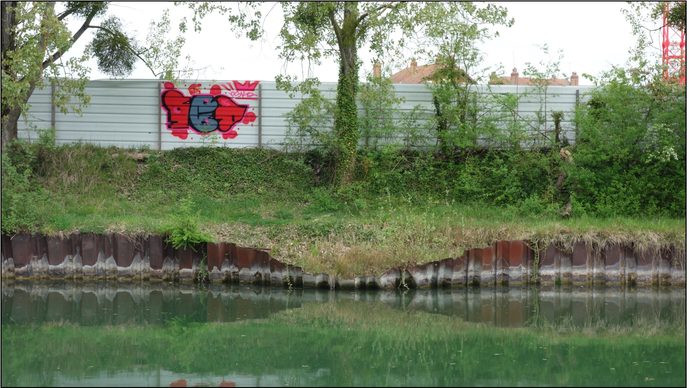
Rive Droite km 0,510, palplanches effondrées
