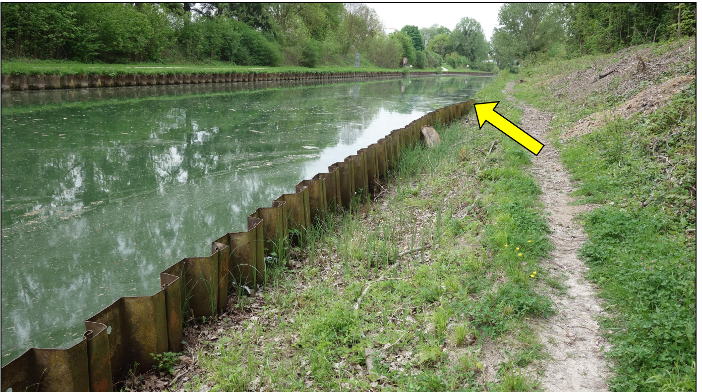
Rive Droite km 0,272, affaissement de la zone de palplanches surélevées post-écluse
