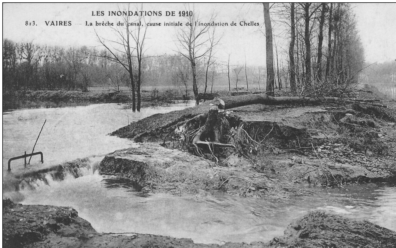
C.P.A n°2 : La Brèche « amont » du canal de Chelles (à droite, la digue et ses peupliers, la ligne de peupliers de la rive droite au fond, se reflétant dans le canal)
