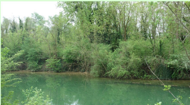
R6 km 1,480 à 1,520, gros affouillement de la rive, palplanches noyées
