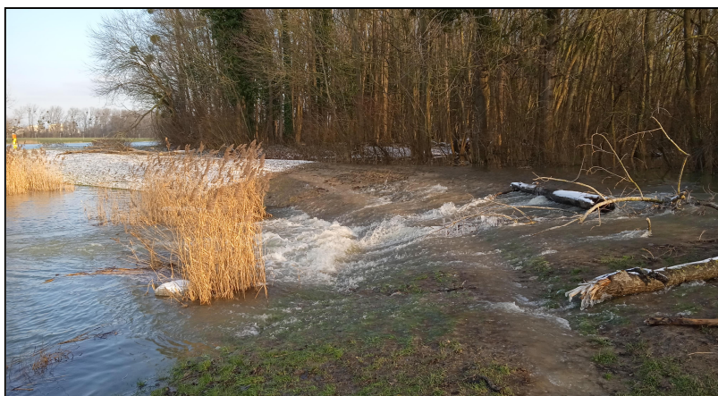
Surverse lors de la crue de 2021 sur la rive sud du lac de Vaires, au niveau du tassement de l'ancienne évacuation de la carrière de sable Morillon-Corvol
