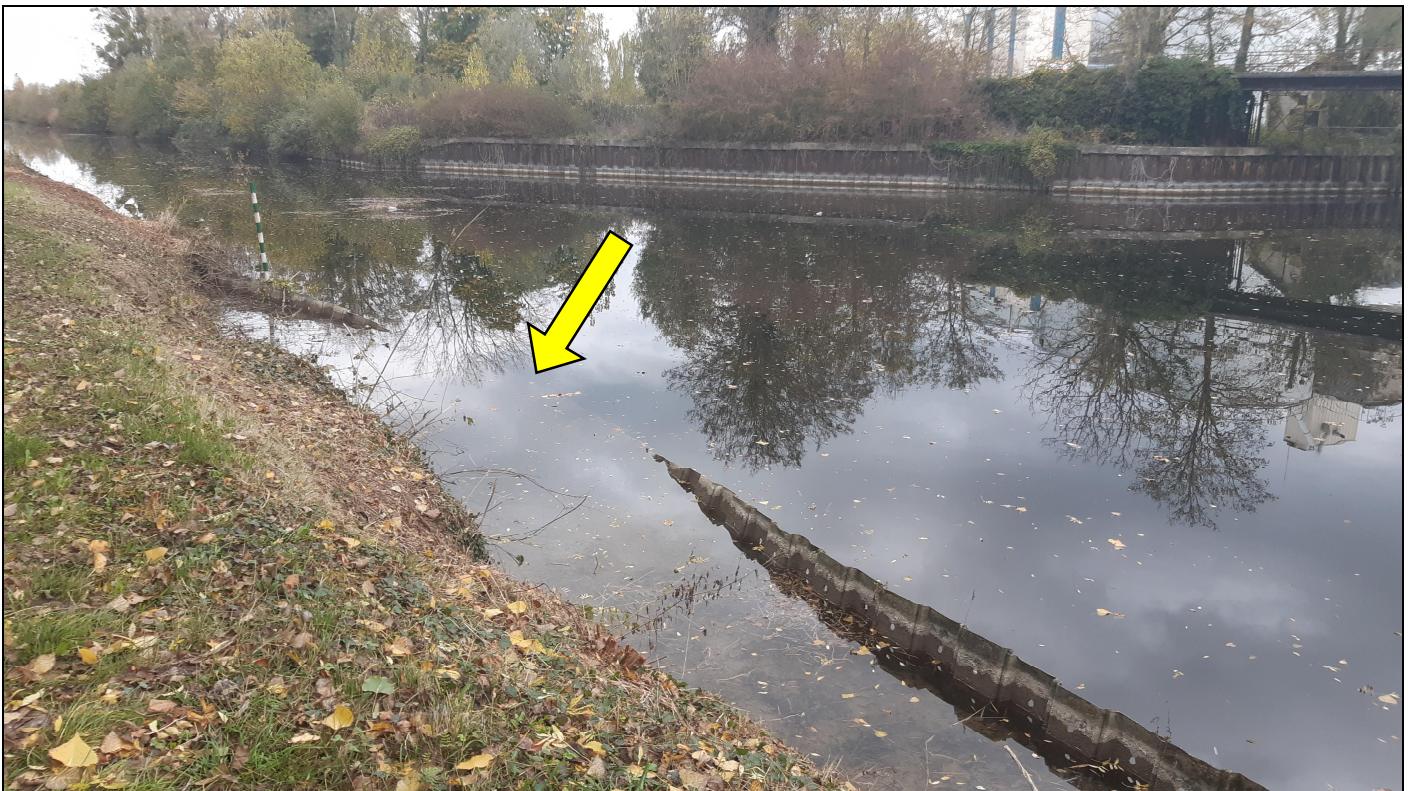
Rive Gauche km 3,725, palplanches effondrées et noyées face à l'entrée du quai Calcia
