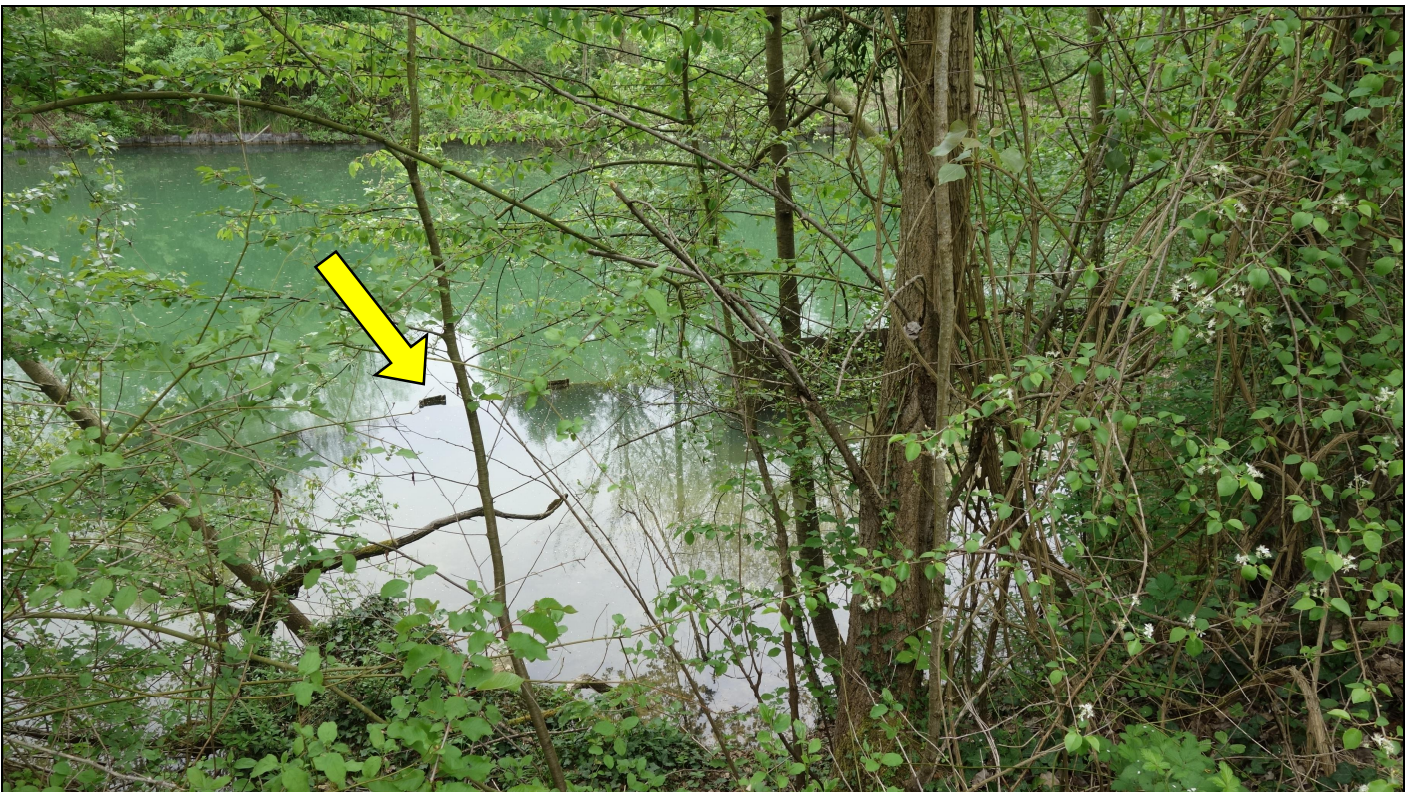
Rive Droite km 1,368, palplanches noyées et disparition du chemin de contre-halage
