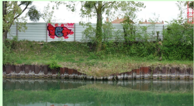
RD km 0,510, palplanches effondrées
