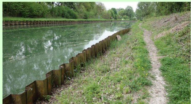
RD km 0,272, affaissement de la zone de palplanches de 1m post-écluse
