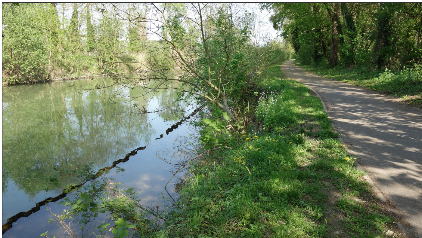
Rive Gauche km 3,725, palplanches noyées et rive creusée, vue vers l'amont, mai 2018
