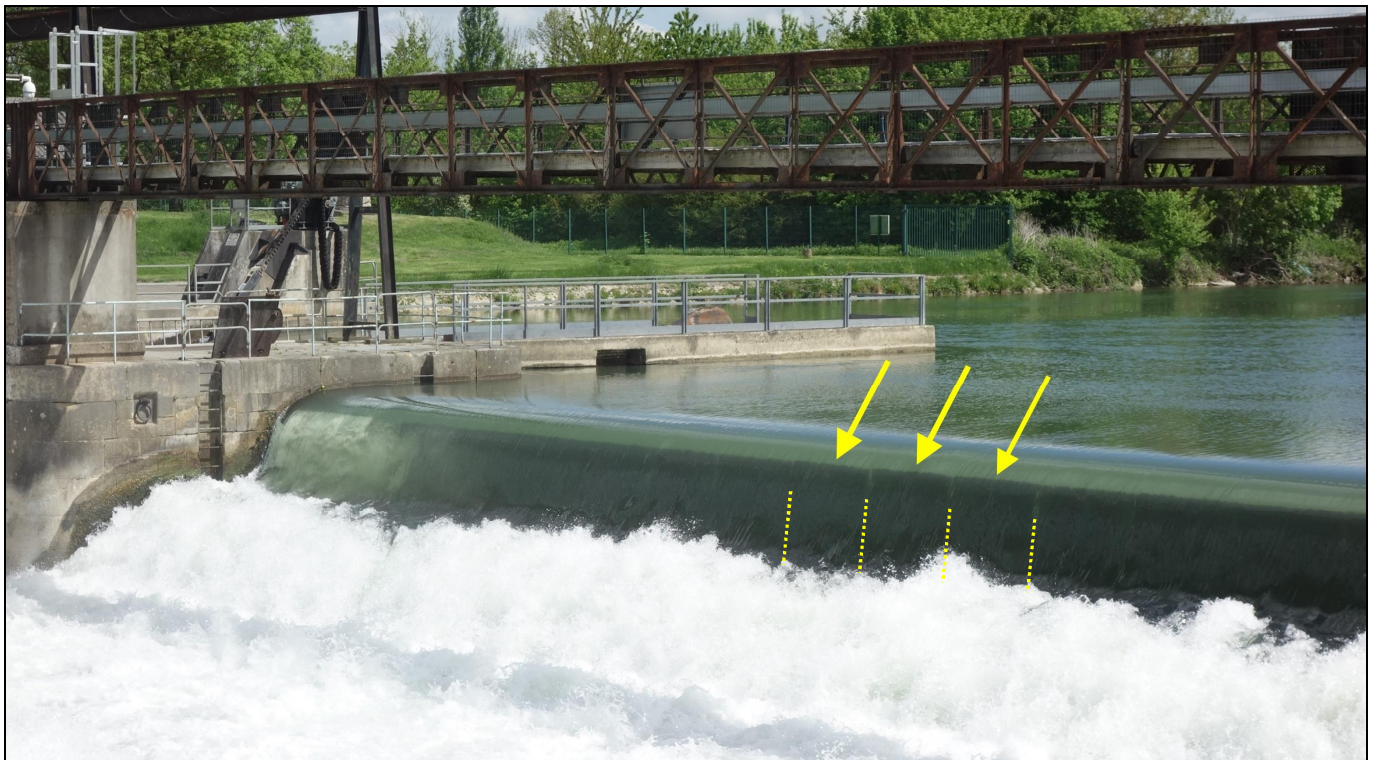
Sur cette vue rapprochée, on devine, sous le sommet de la chute, les hausses mobiles en position haute. L'intervalle entre chaque hausse correspond aux tôles séparatrices des caissons noyés, dans lesquels les hausses se logent en position abaissée.
